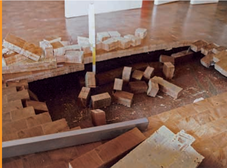
Aufwölbung eines Holzpflaster-Fußbodenbelages durch Nässeinwirkung auf den Kleber
