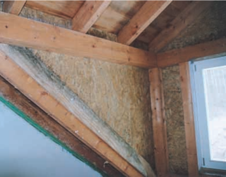
Neubau im fortgeschrittenen Ausbaustand: Schimmelpilzbefall an Holz- und Holzbauteilen einer Gaube
