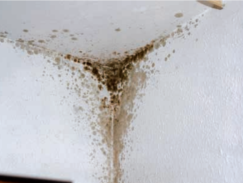
Schimmelpilz in der Raumkante eines Wohnzimmers
