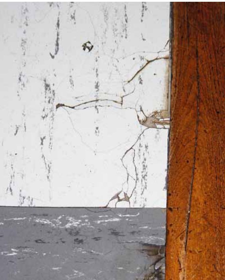
Gefahr droht, wenn Heimwerker asbesthaltige Floorflex-Platten entfernen
