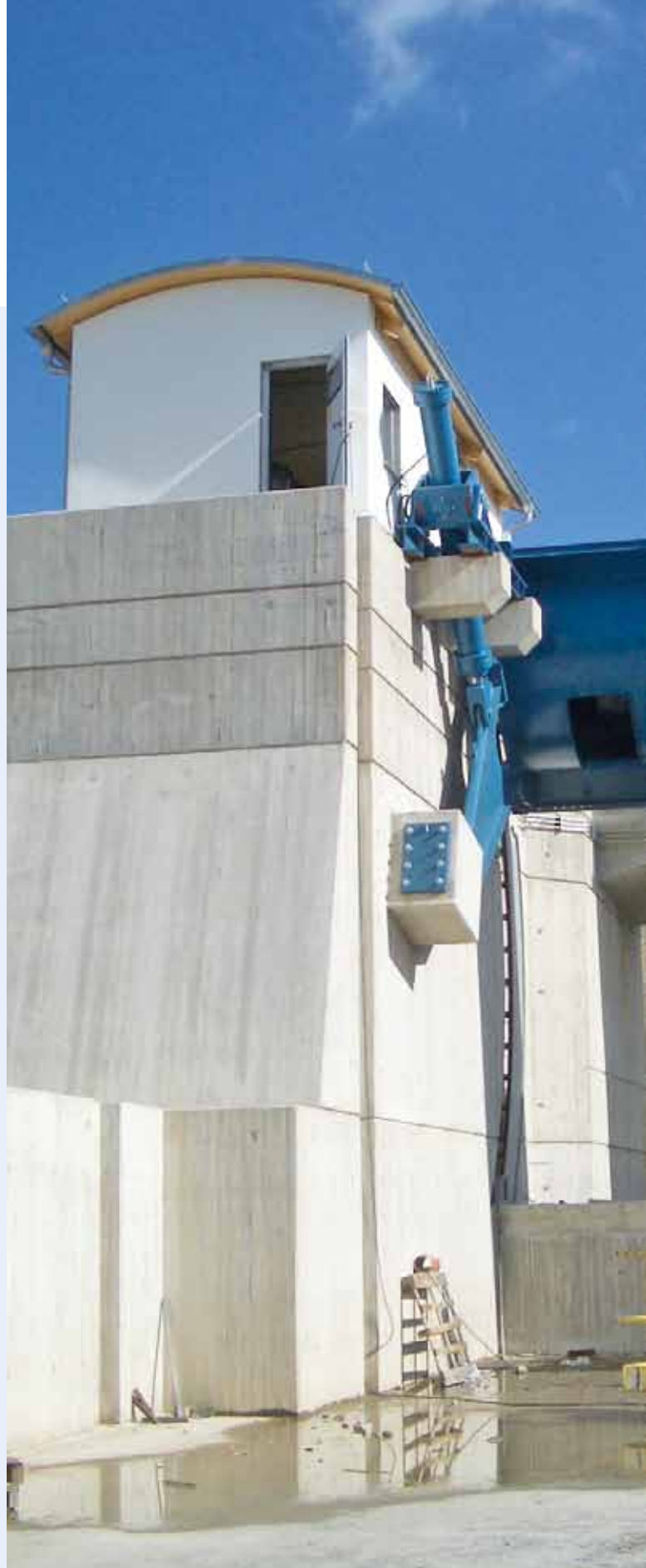
Der mittlere Pfeiler trägt das Betriebsgebäude mit der Hydraulikpumpe
