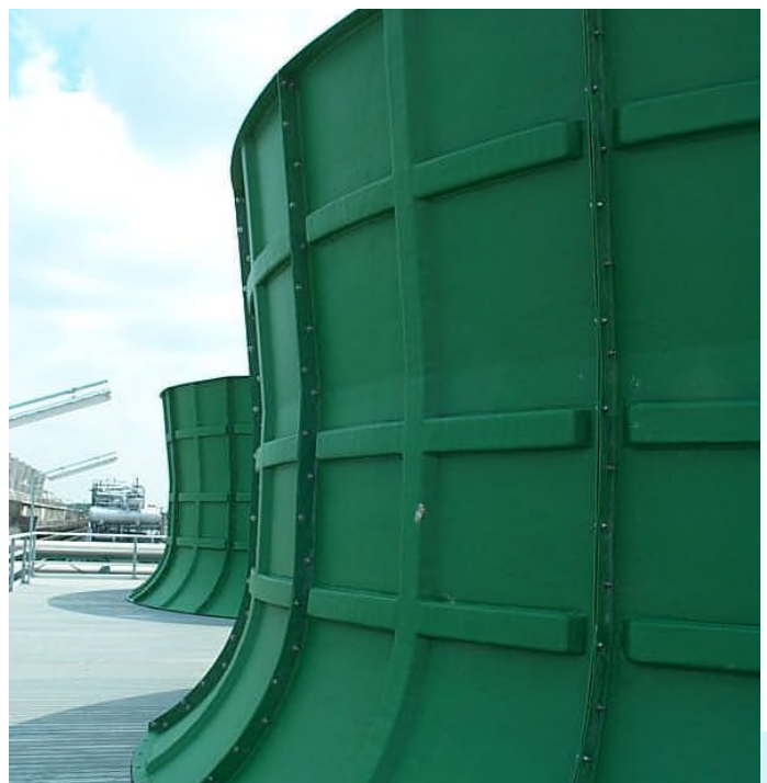
Kühlturmdeck mit Diffusoren
