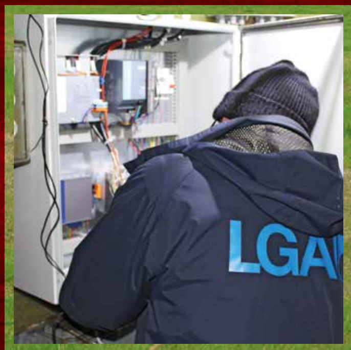
LGA-Sachverständiger Mario Barnjak installiert semiintelligentes Messsystem im Herzen des Turms.
