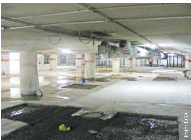
Betonabtragsflächen an einer Tiefgaragenbodenplatte nach Auswertung der Potentialfeldmessung
