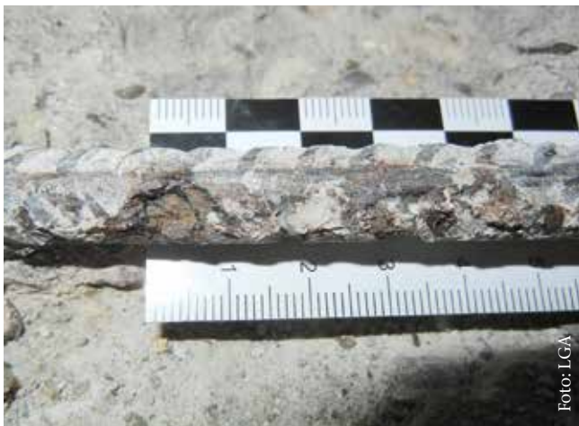
Sondieröffnung, Stahlbeton-Bewehrung mit Lochfraß-Korrosion
